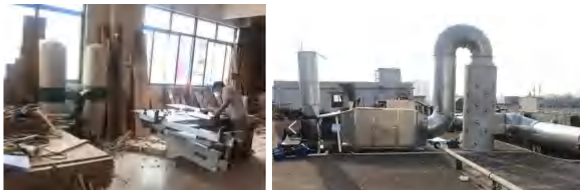
图 5 木工车间粉尘、打磨粉尘及喷漆废气处理设施
