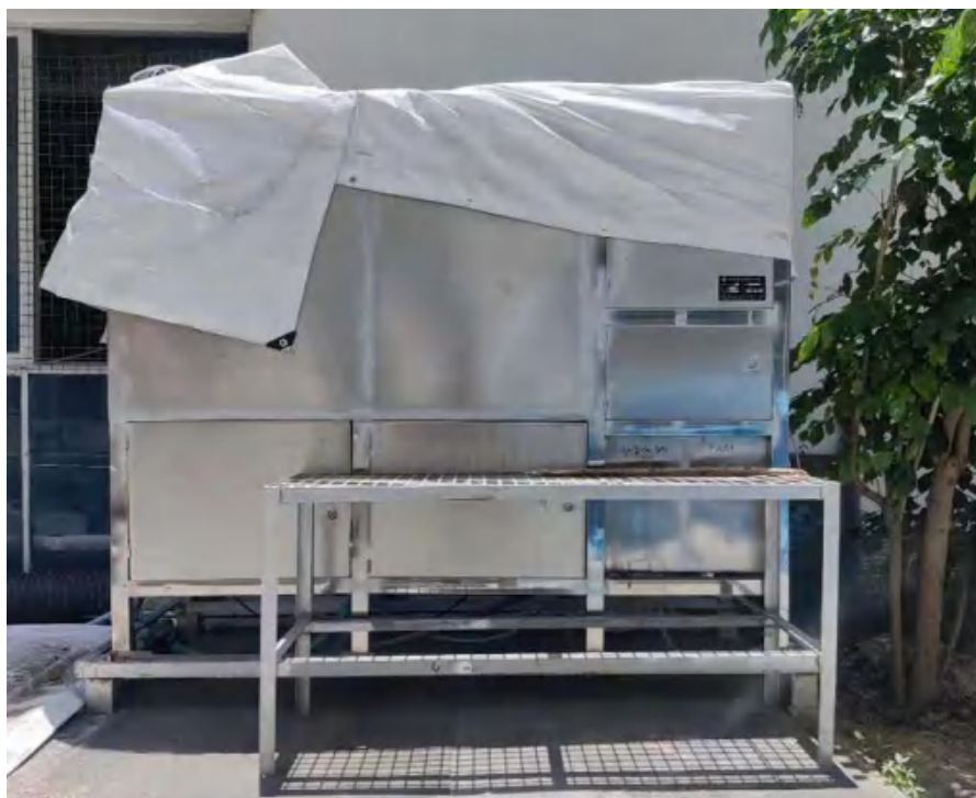
图4 污水处理设施
